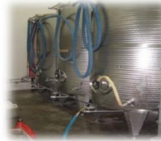
Citernes de stockage
